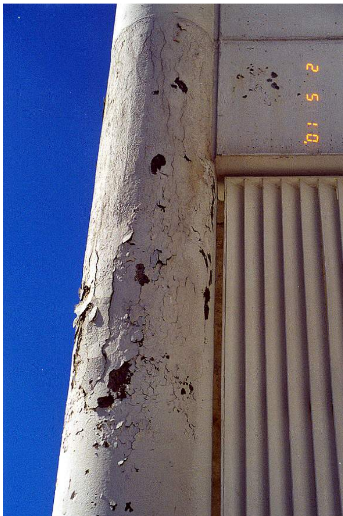
Kuva 4 Betonin pakkasrapautumisen aiheuttamaa pinnan halkeilua
