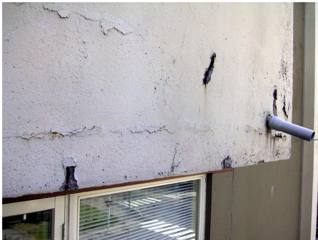
Kuva 3 Terästen korroosiovaurioita parvekkeen kaitteessa
