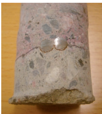
Kuva 5 Terästen korroosiota karbonatisoituneessa betonissa voidaan hidastaa suojaavilla pinnoitteilla.
