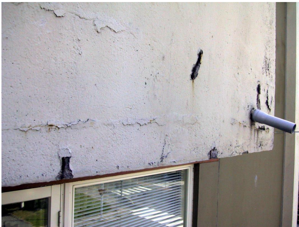
Kuva 3 Terästen korroosiovaurioita parvekkeen kaitessa.
