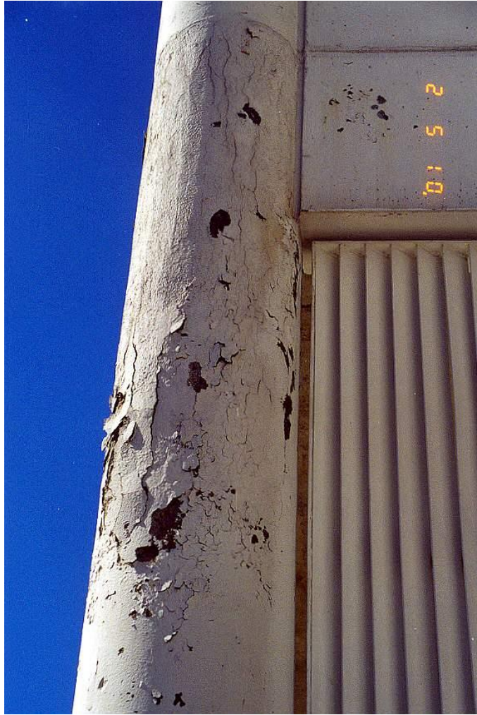
Kuva 4 Betonin pakkasrapautumisen aiheuttamaa pinnan halkeilua.
