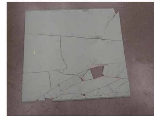
Rikkoonut onnettomuusparvekkeen levy rekonstruktion jälkeen. Levy on samassa asennossa kuin ollessaan kiinnitettynä alumiinirunkoon, julkisivupuoli näkyvissä. (Kuva: OTKES)
